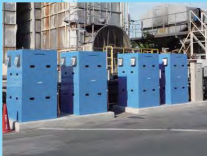
工場排水 処理設備能力増強 貧酸素・臭気対策(酸素ガスUFB)
