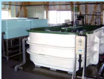
魚類蓄養システム (酸素ガスUFB)
